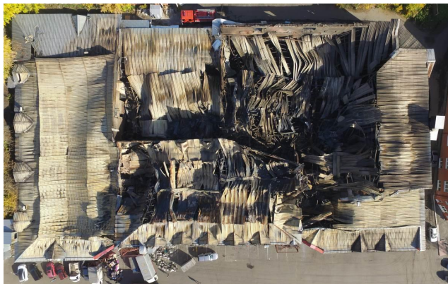
Рис. 1. Фотоснимок термических повреждений гипермаркета, полученный с использованием БПЛА
